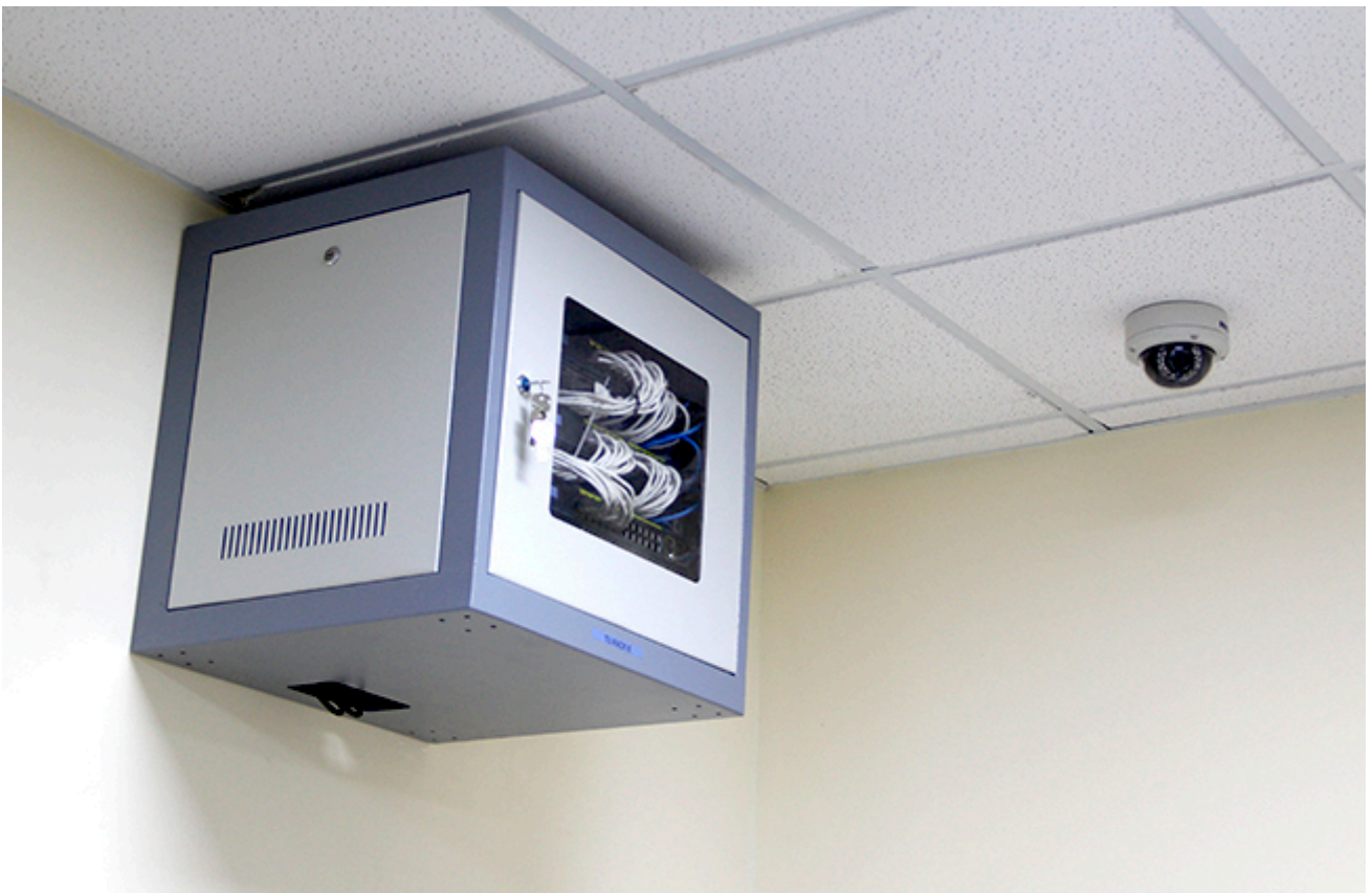
Tủ mạng, camera giám sát và hệ thống điều hòa
